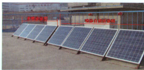
图8 自组装太阳能光伏电板
